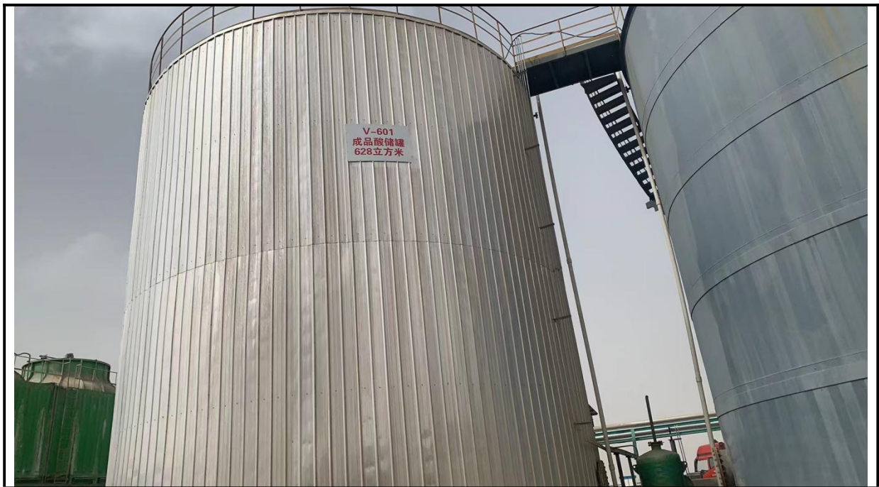
图 3.3-2 成品硫酸储罐
