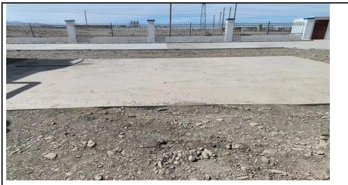
图 4.2-3 初期雨水收集池
