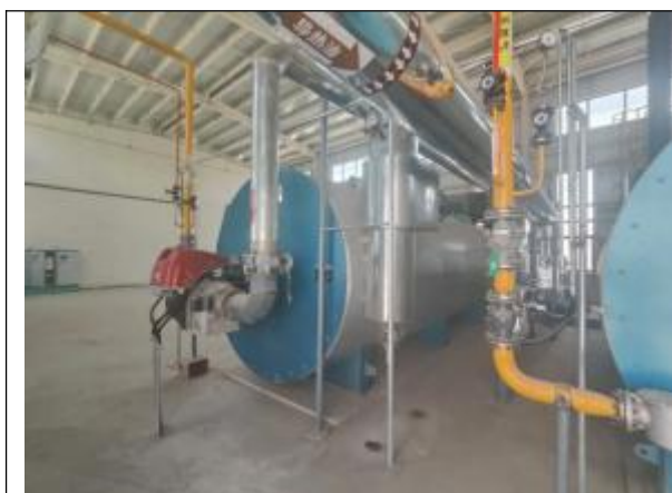
低氮燃烧锅炉
