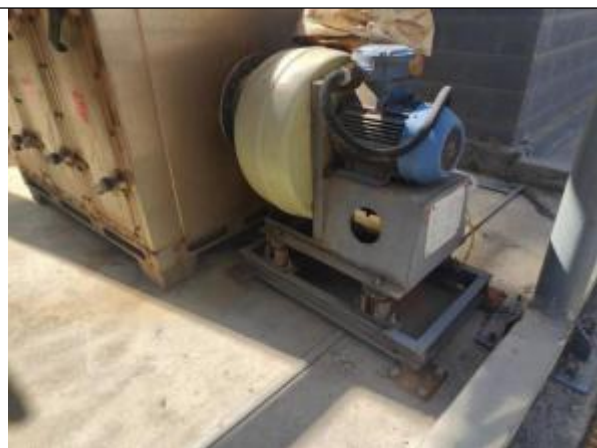
基础减震设施
