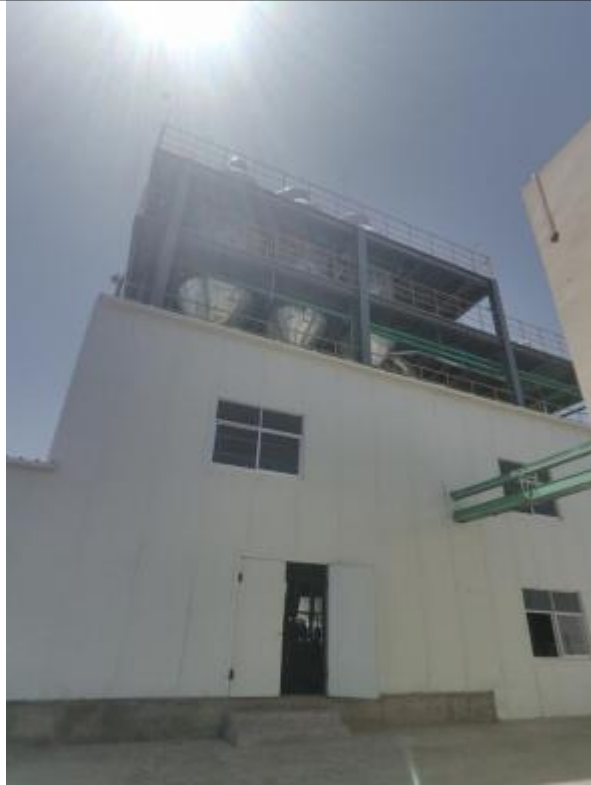
污水处理站三效蒸发器
