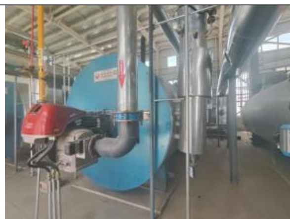
低氮燃烧锅炉
