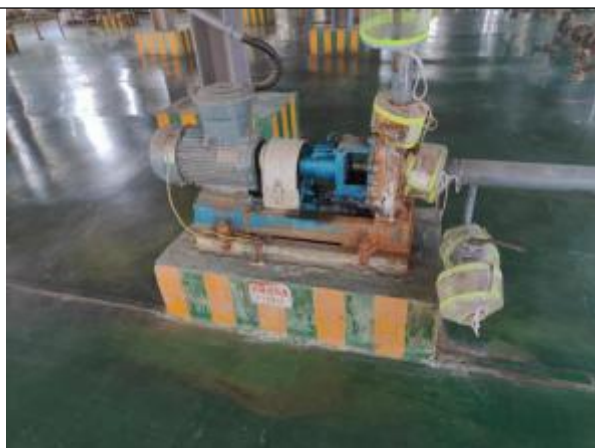
基础减震设施
