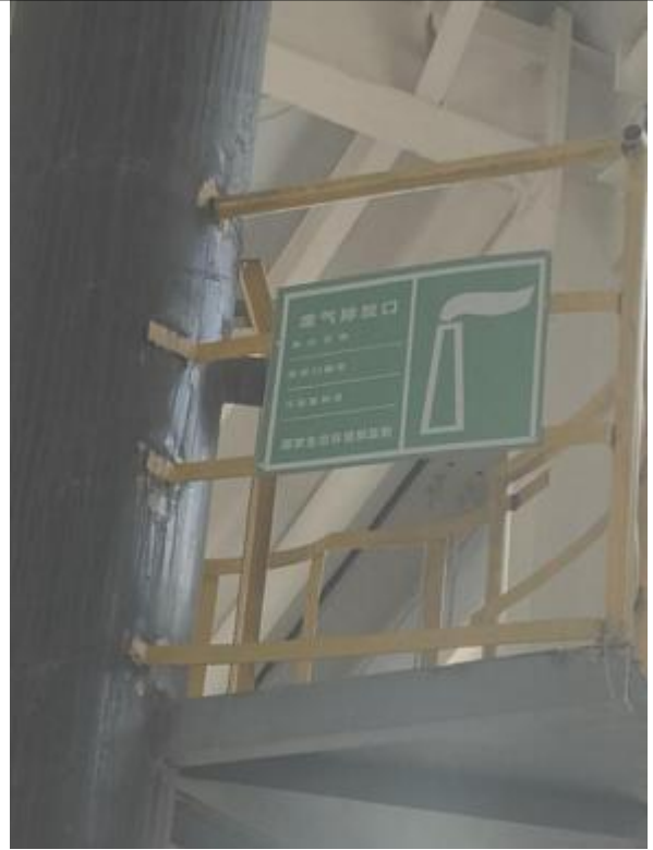
3#锅炉监测平台及标识牌
