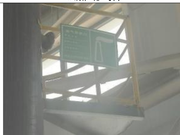
1#锅炉监测平台及标识牌
